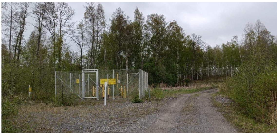
Kuva 16. Kaava-alueella sijaitseva maakaasun venttiiliasema.
